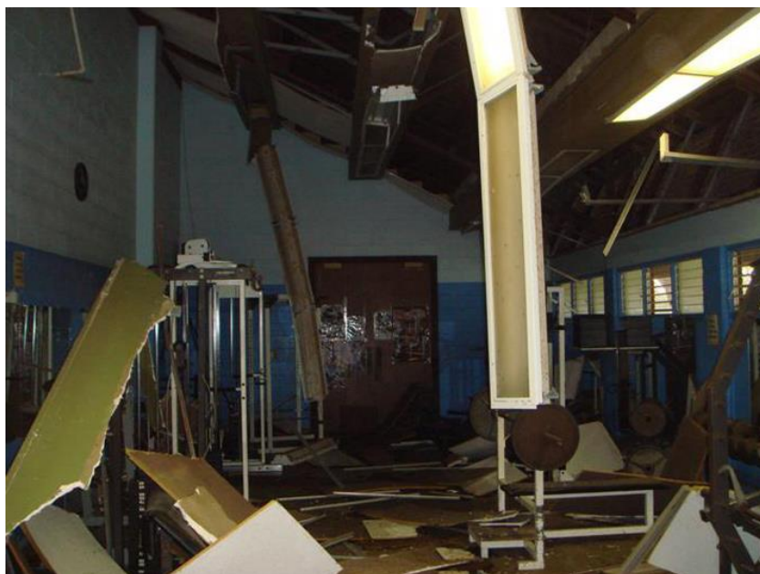
תרשים 9.2 התמוטטות תקרות אדריכליות תלויות היו נפוצות עקב רעידת האדמה בהוואי 2006. גופי התאורה והצנרת התלויים מהווים גורם סיכון לא מבני. EERI Special Earthquake Report – December 2006, “ Preliminary Observations on the Hawai`i Earthquakes of October 15, 2006 “
