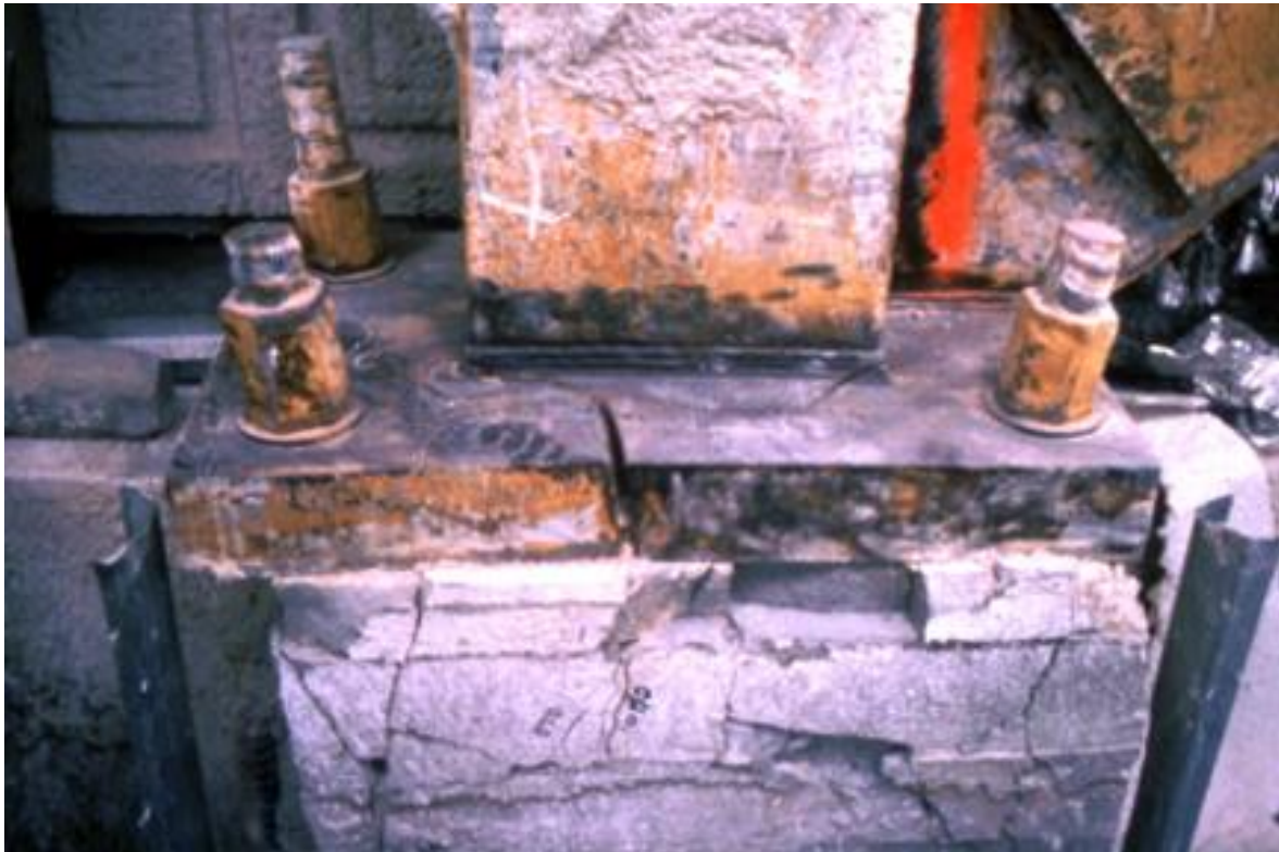
תרשים 7.2 כשל בכפיפה של פלטת בסיס של עמוד פלדה ברעידת האדמה Northridge, קליפורניה 1994 Oviatt Library photo gallery, California State University, Northridge
