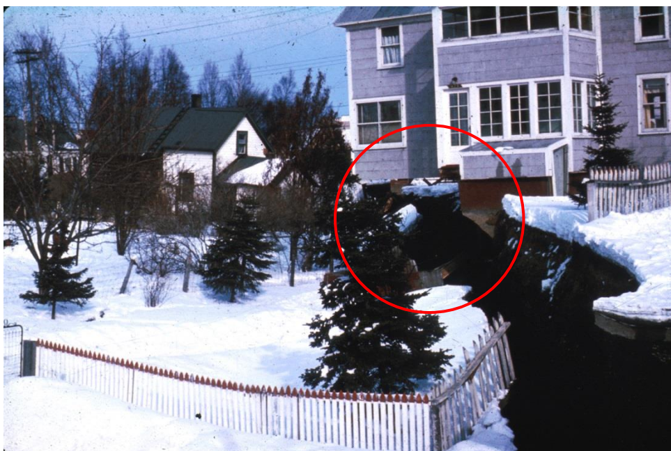
תרשים 8.2 אבדן השענה ונוזק למבנה עקב קו שבר תחת המבנה, אלסקה 1964. USGS Geological Survey photographic library
