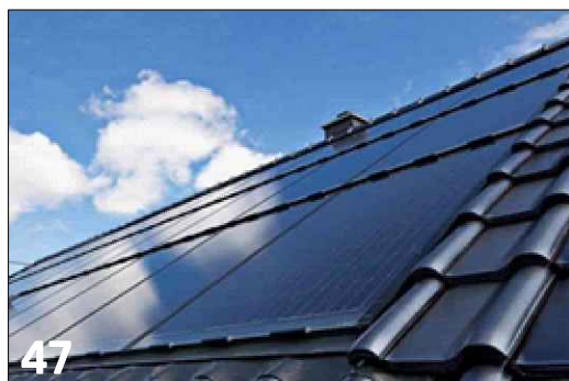
47 In het dak geïntegreerde zonnepanelen
