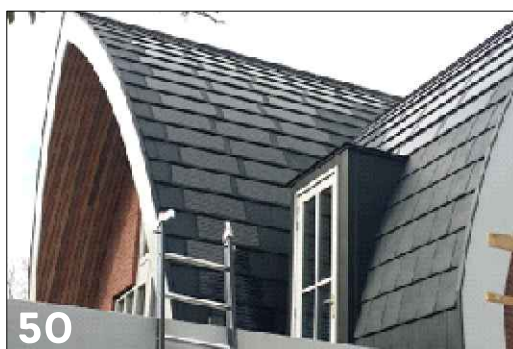
50 Zonnepanelen verwerkt in bijzondere dak vorm
